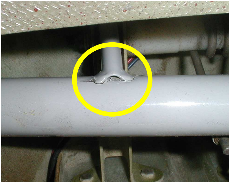
Abbildung 3: Schaden von vorn
